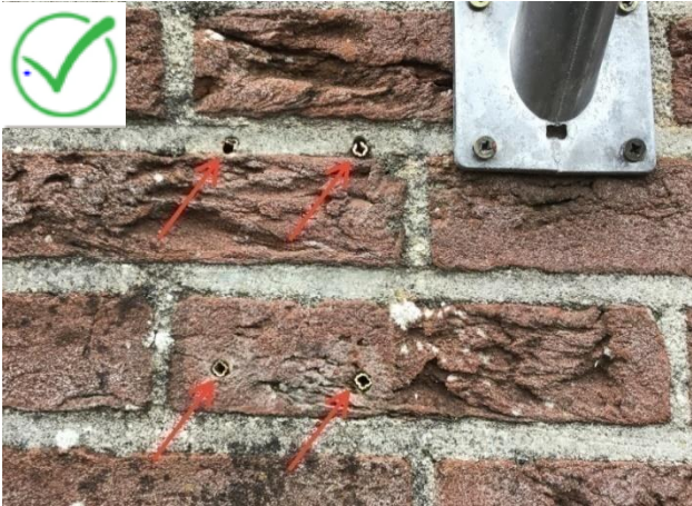
Afb 4: Voorbeeld clustering van mechanische schades. Deze mogen geclusterd worden.
