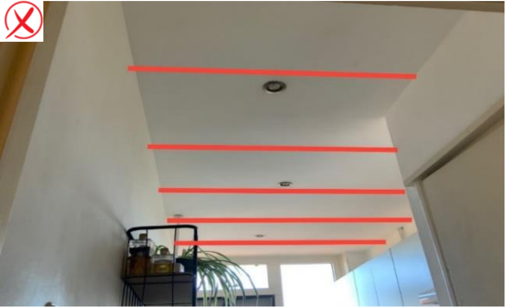
Afb. 7: In de bovenstaande afbeelding lopen de scheuren niet in het verlengde van elkaar. Dit betekent dat de schades niet geclusterd mogen worden. De schades dienen dus apart opgenomen te worden.
