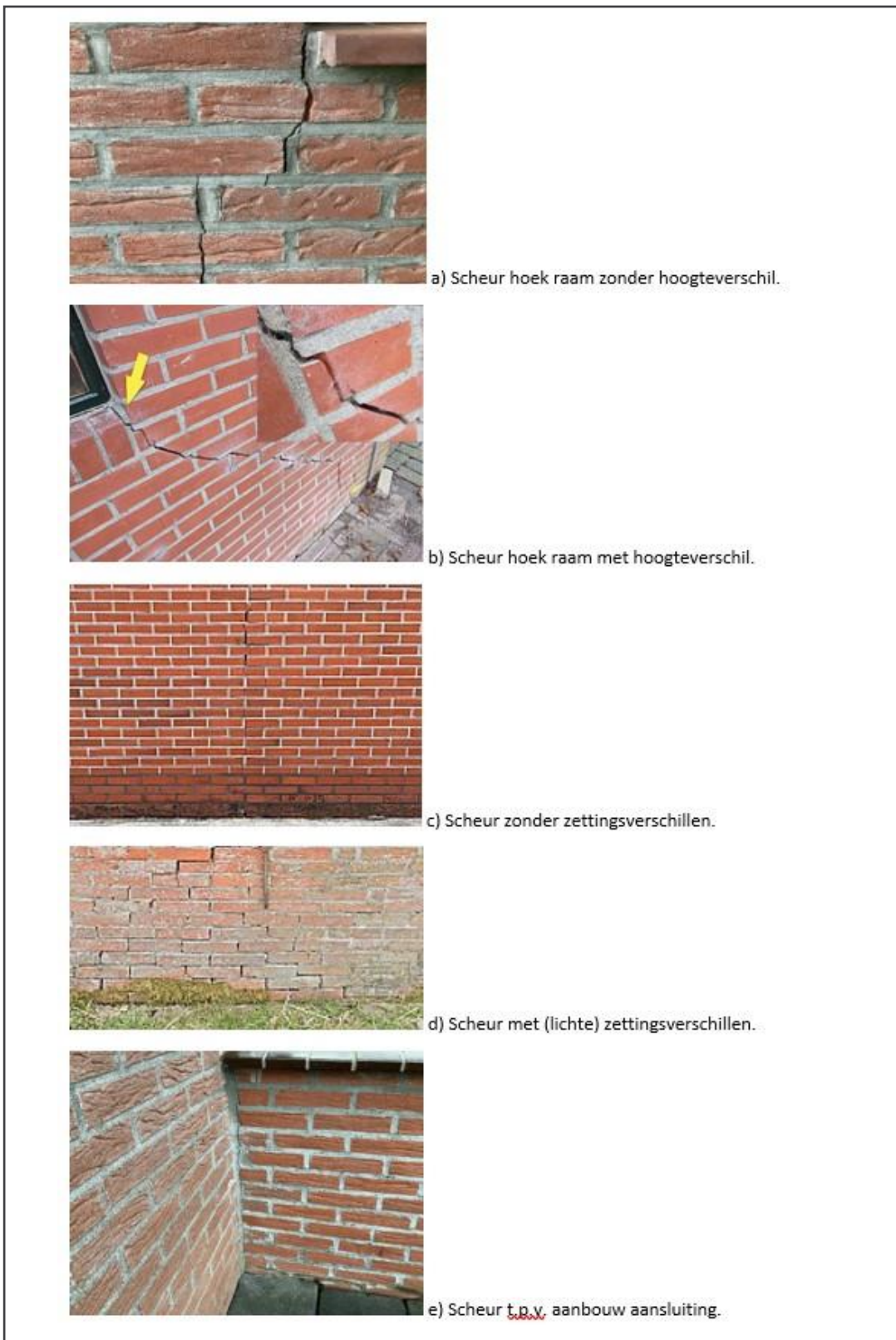
Figuur 2.5 Voorbeelden van funderingsgerelateerde schades in metselwerk
